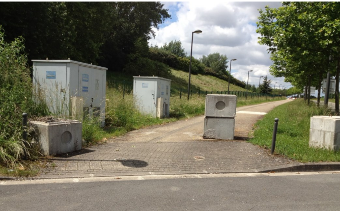
Circuit Carole, alimentation éclairage
