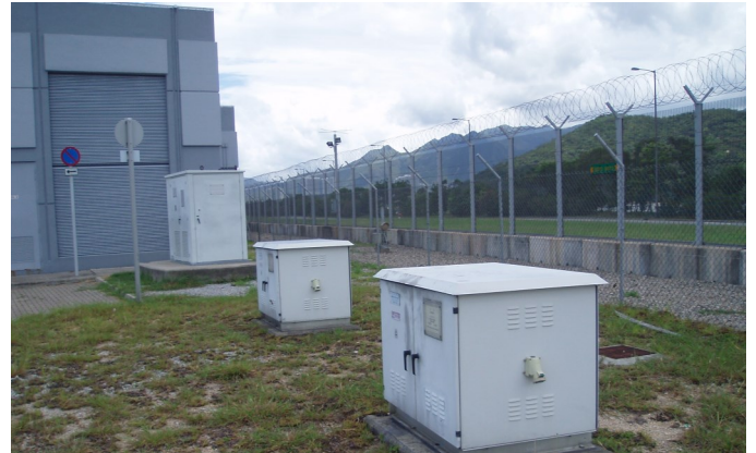
Aéroport de Hong Kong, éclairage clôture
