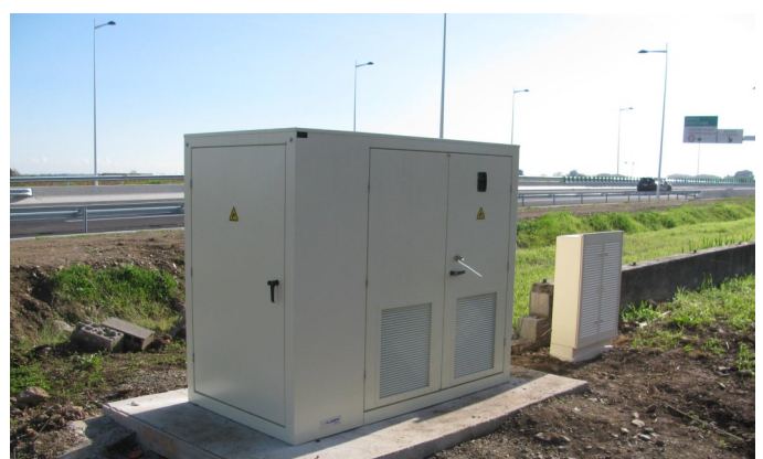
Rocade de Borgo, alimentation de l'éclairage
