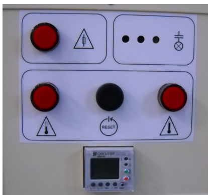
Panneau de signalisation et contrôle
