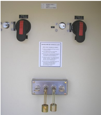
Interrupteurs 950 V + verrouillage
