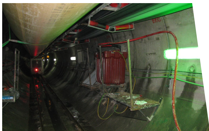
Tunnel, Espagne, alimentation éclairage et prises
