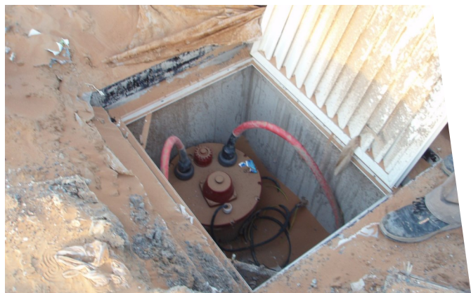
Aéroport, Moyen Orient, alimentation éclairage
