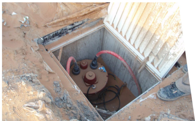
Aéroport, Moyen Orient, alimentation éclairage
