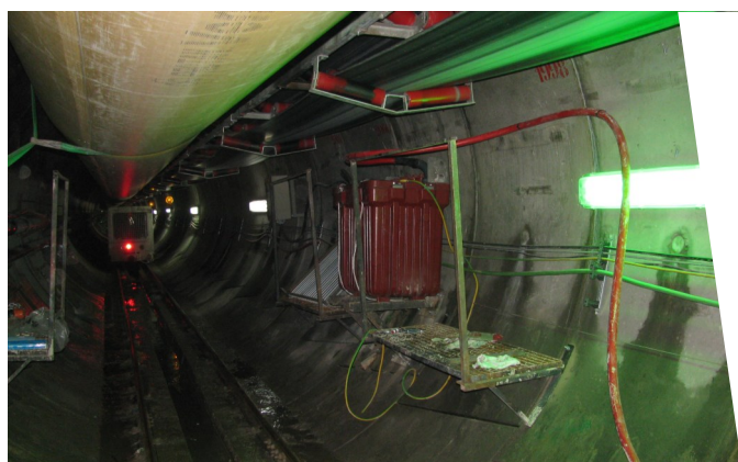
Tunnel, Espagne, alimentation éclairage et prises
