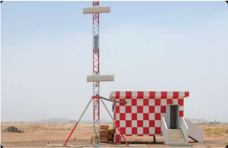
TAMRASSET, ALGERIE – Alimentation des aides à la navigation
