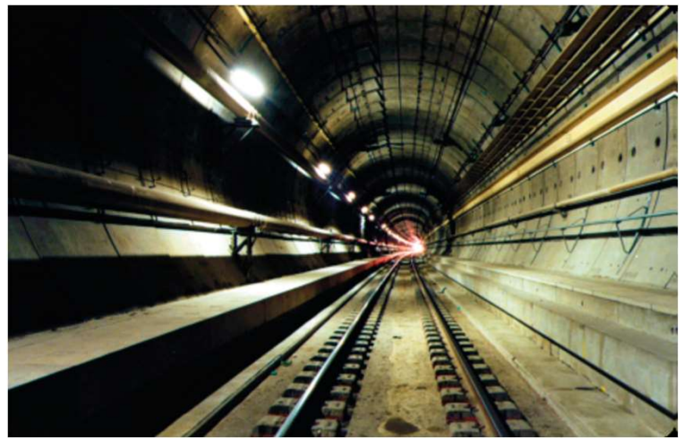
EUROTUNNEL, ROYAUME-UNI – Eclairage parking et phase travaux
